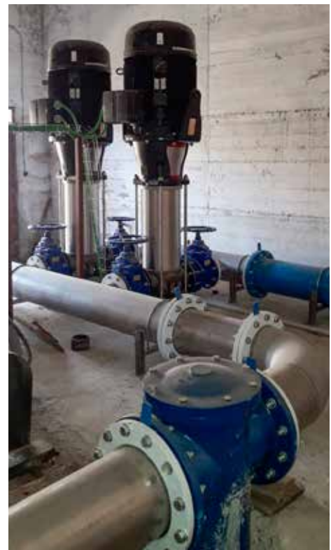
Dos bombas CRN de Grundfos aportan un suministro de agua fiable a miles de personas.
