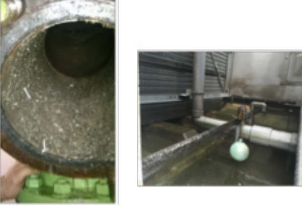
Resim 2: Soğutma kulesinin borularında ve rezervuarında biyofilm oluşumu
