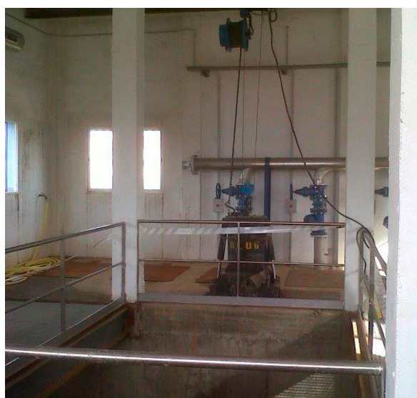
Pogled unutar crpne stanice.
