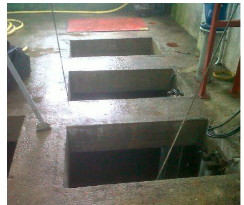
Crpne jame. Crpke su mokro instalirane.
