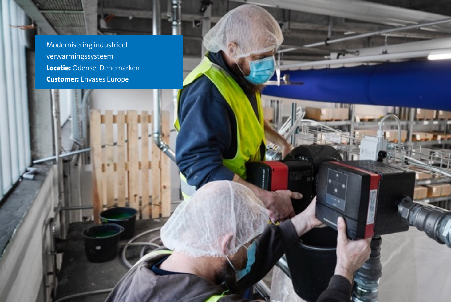
Afbeelding: De installatie van een MIXIT-eenheid naast een MAGNA3-circulatiepomp voor het Envases HVAC-systeem.
