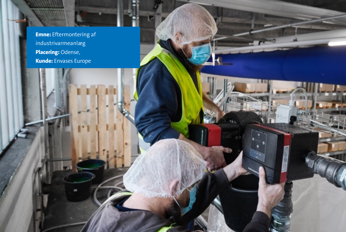
Billede: Installation af en MIXIT-enhed med en MAGNA3-cirkulationspumpe i Envases HVAC-anlæg.
