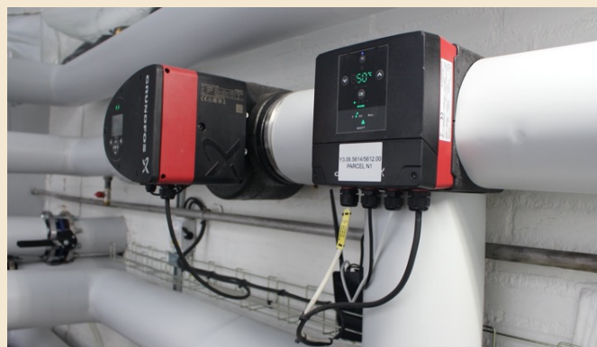
Billede: Blandesløjfen efter eftermontering af MIXIT. Grundfos MIXIT-enheden ses til højre, og til venstre ses en Grundfos MAGNA3-cirkulationspumpe.
