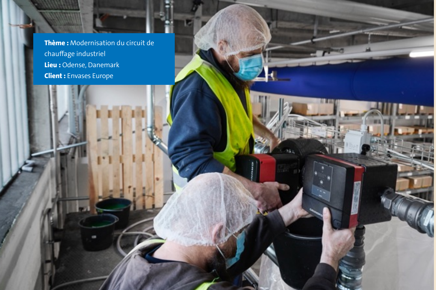
Image : Installation d'une unité MIXIT associée à une pompe de circulation MAGNA3 pour le système HVAC Envases.
