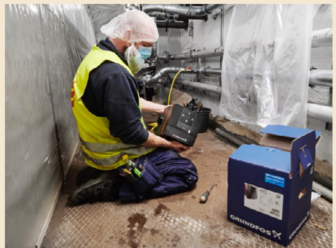
Image : Installation de Grundfos MIXIT chez Envases à Odense, Danemark.
