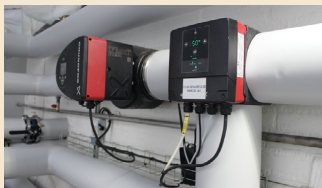
Kép: A keverőkör a MIXIT beépítése után. Jobbra a Grundfos MIXIT egység, balra pedig egy Grundfos MAGNA3 keringetőszivattyú található.
