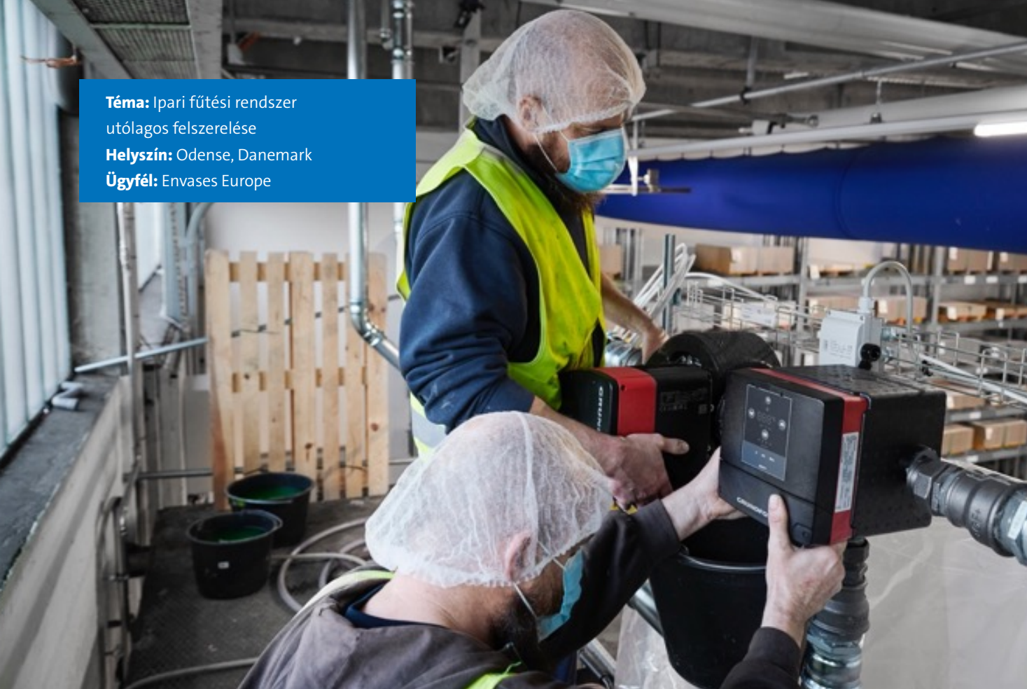
Kép: MIXIT egység telepítése MAGNA3 keringetőszivattóval az Envases HVAC rendszerhez.
