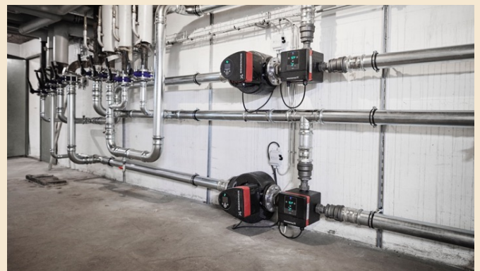
Afbeelding: Twee geïnstalleerde menggroepen met Grundfos MIXIT's en MAGNA3's bij Envasen.
