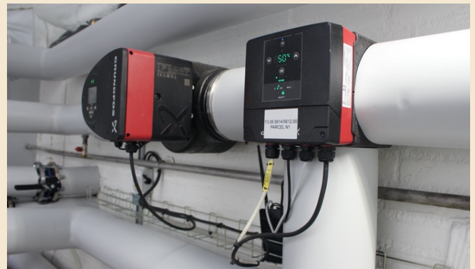
Afbeelding: De menggroep na de modernisering met MIXIT. De Grundfos MIXIT-eenheid bevindt zich rechts. Links is de Grundfos MAGNA3-circulatiepomp geïnstalleerd.
