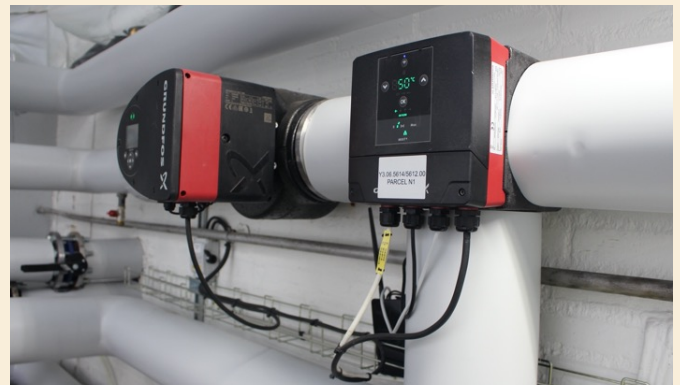
Abbildung: Der Mischkreis nach der Nachrüstung mit MIXIT. Die MIXIT-Einheit von Grundfos befindet sich rechts und eine MAGNA3-Umwälzpumpe von Grundfos links.
