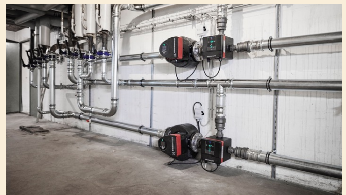
Abbildung: Zwei neu installierte Mischkreise mit MIXIT-Einheiten und der MAGNA3 von Grundfos bei Envases
