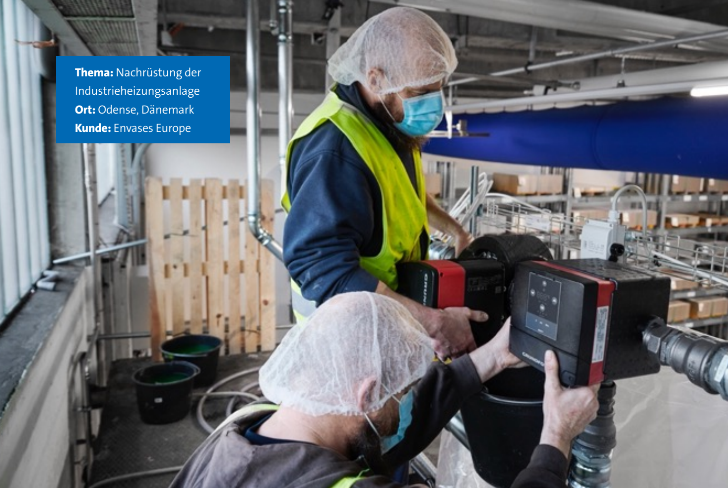
Abbildung: Installation einer MIXIT-Einheit mit einer MAGNA3-Umwälzpumpe für die HLK-Anlage von Envases
