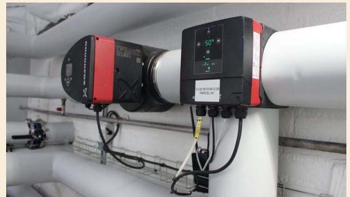
Abbildung: Der Mischkreis nach der Nachrüstung mit MIXIT. Die MIXIT-Einheit von Grundfos befindet sich rechts und eine MAGNA3-Umwälzpumpe von Grundfos links.
