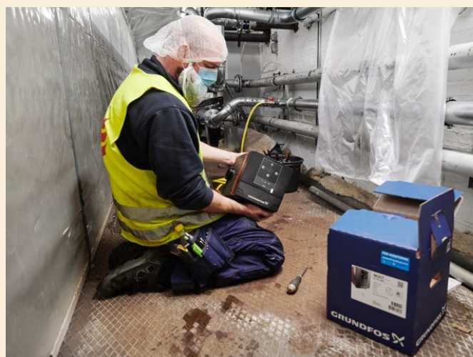
Abbildung: Installation von Grundfos MIXIT bei Envases in Odense (Dänemark).
