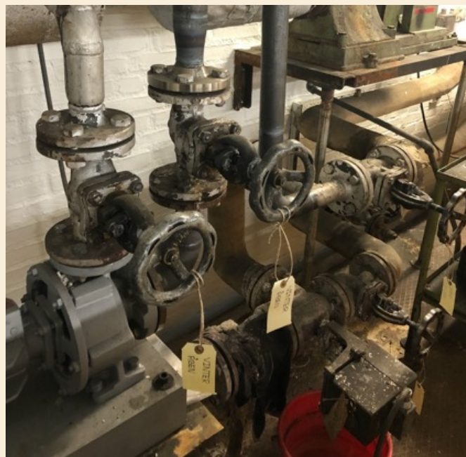
Image : Une boucle de mélange Envases avant la modernisation MIXIT.
