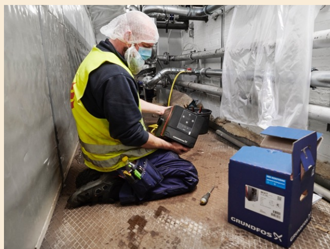
Slika: Instaliranje Grundfos MIXIT jedinice na Envases (Odense, Danska).
