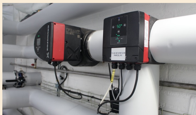
Slika: Hidraulički krug sa mešanjem nakon rekonstrukcije MIXIT-a. Grundfos MIXIT je sa desne strane, a sa leve strane je Grundfos MAGNA3 cirkulaciona pumpa.
