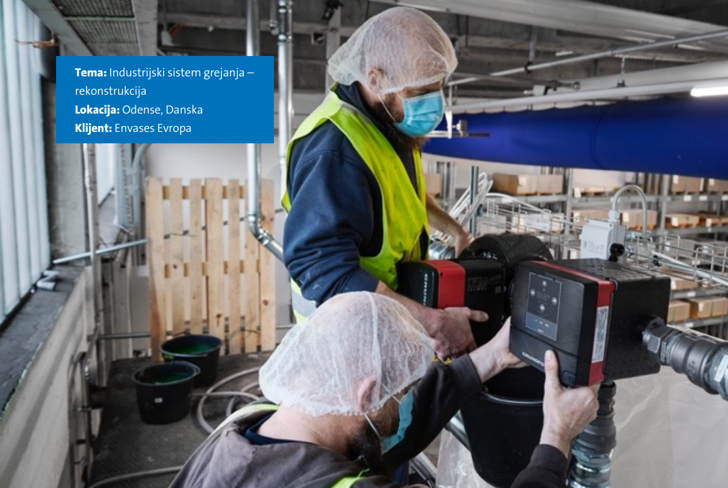
Slika: Instalacija MIXIT-a uz pomoć MAGNA3 cirkulacione pumpe za Envases HVAC sistem.
