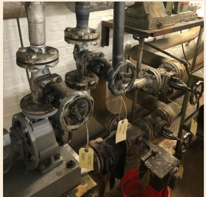
Abbildung: Ein Mischkreis von Envases vor der Nachrüstung mit MIXIT.
