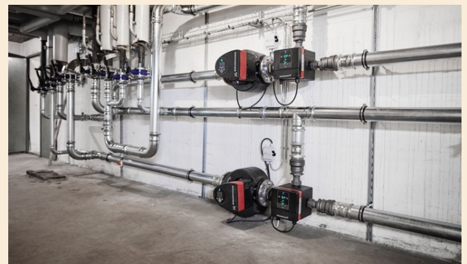
Abbildung: Zwei neu installierte Mischkreise mit MIXIT-Einheiten und der MAGNA3 von Grundfos bei Envascs
