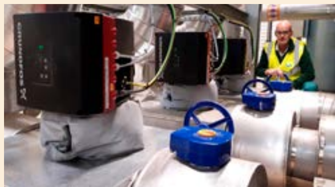
George Nicholls, Arla Foods, et les nouvelles pompes TPE pour le système d'eau glacée
