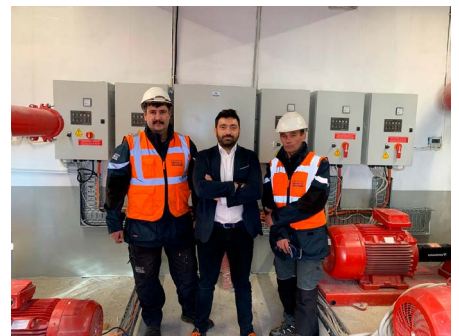
Mr. Daniel-Robert Dragomir (กลาง) ผู้จัดการฝ่ายบริการและโซลูชันประจำ Grundfos Romania ยืนอยู่กับทีมงานบริการด้านเทคนิคของ Grundfos Bogdan Draghici และ Mr. Dan Meluta ในห้องระบบบีนดับเพลิงของ Dedeman
