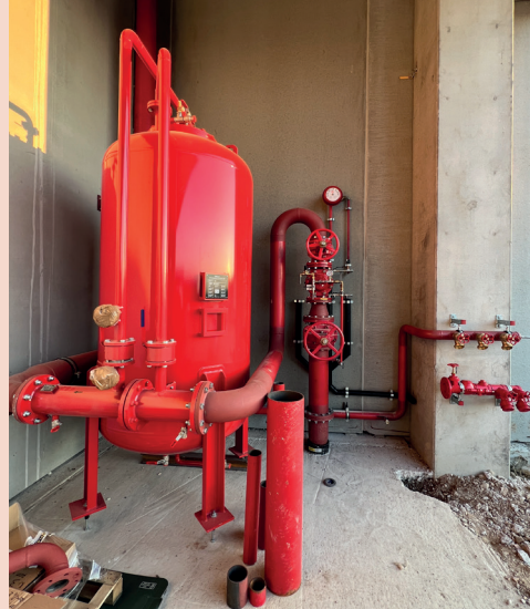
Il premescolatore a servizio dell'impianto a schiuma: elemento chiave nella formazione della miscela acqua-schiumogeno al 3% che alimenta i generatori di schiuma ad alta espansione installati nel magazzino.
