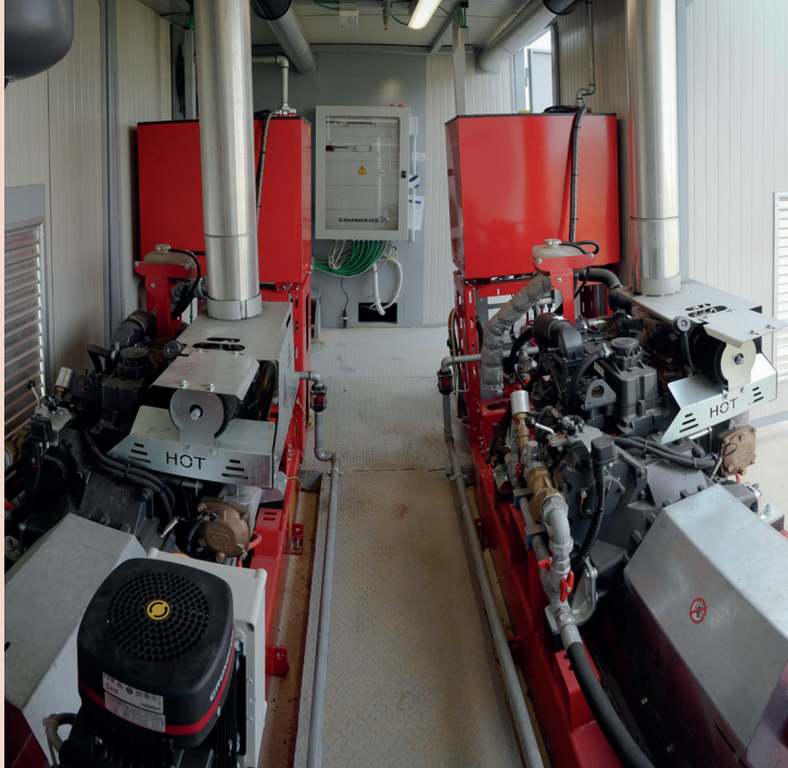
Interno del locale tecnico UNIFIRE, allestito con quadri di controllo, pannelli di allarme e sistemi di ventilazione e illuminazione conformi alla norma.
