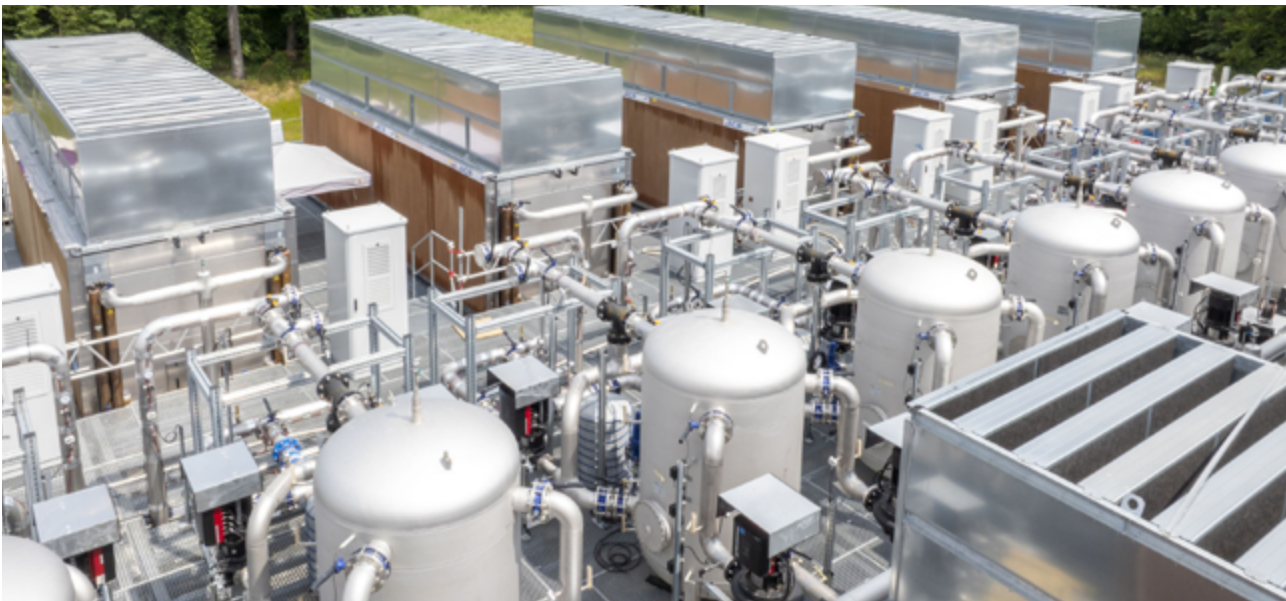
图 14 德国某超算中心温水直接液冷系统现场
