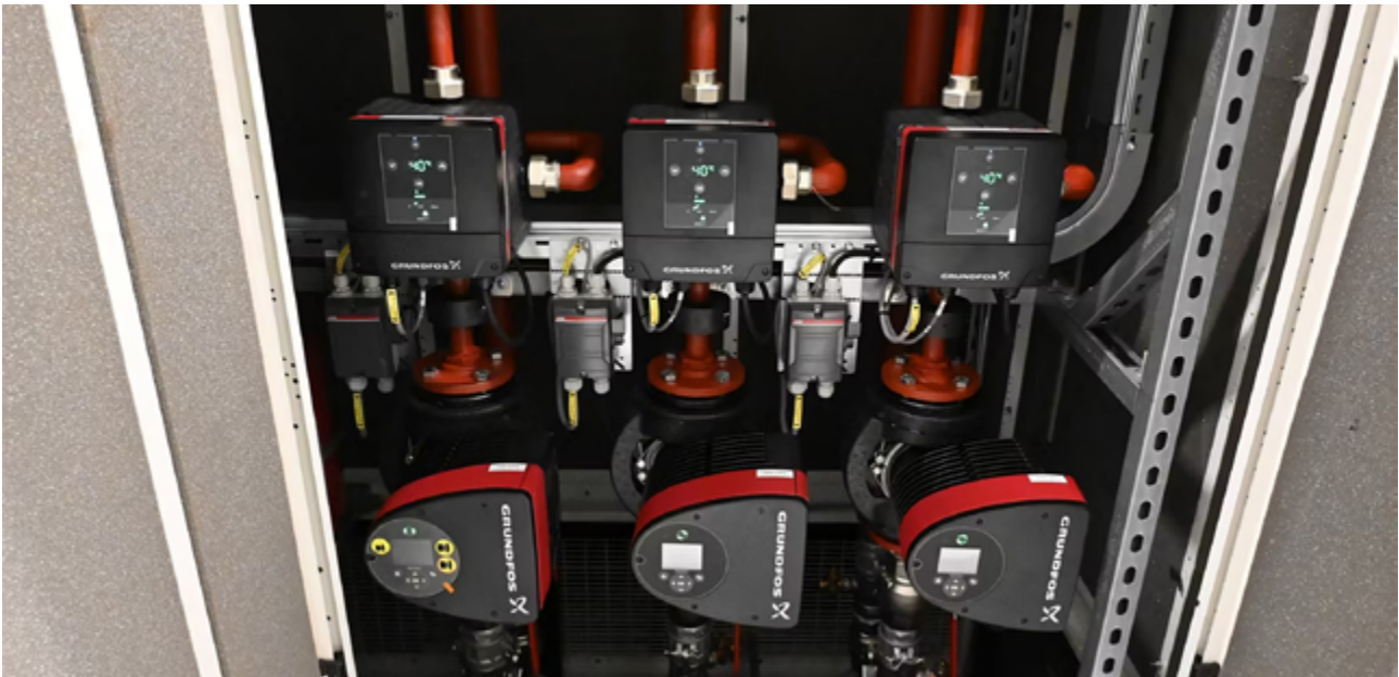
图 11 NorthC 数据中心智能流量调控现场
