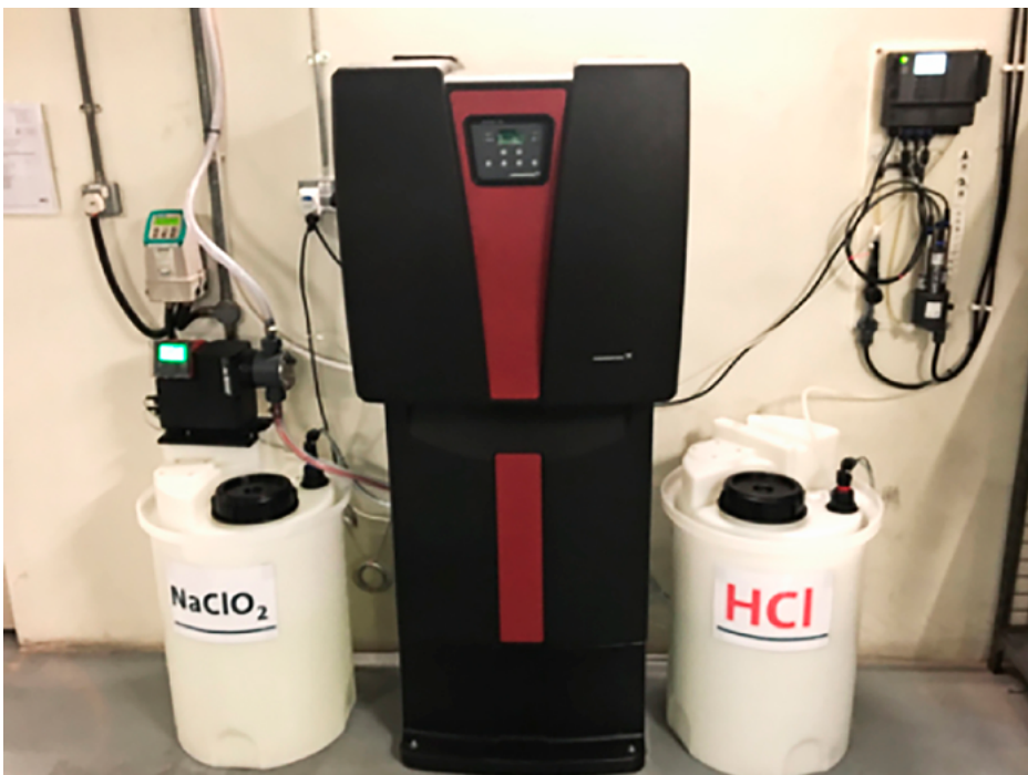
Tour de refroidissement après le nettoyage et générateur de dioxyde de chlore Grundfos Oxiperm installé.
