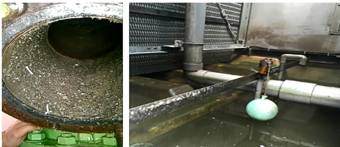
Développement de biofilm dans la tuyauterie et dans le réservoir de la tour de refroidissement.
