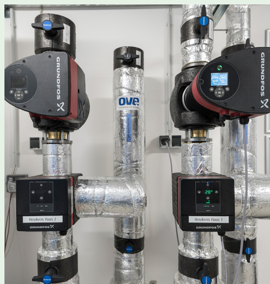
Směšovací smyčky pro první (vpravo) a druhou (vlevo) fázi výstavby. Každá má svoji řídicí jednotku MIXIT a sekundární čerpadlo MAGNA3.
