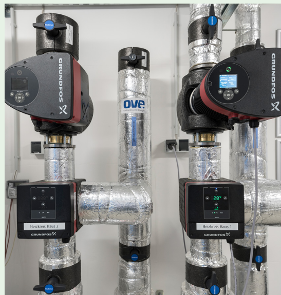
Blandesløjfer til byggefase 1 (til højre) og 2 (til venstre), hver med MIXIT-styreenhed og sekundær MAGNA3-cirkulationspumpe.
