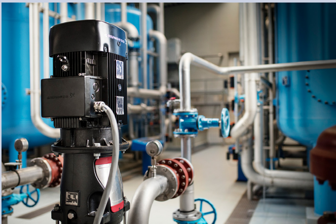
Foto: Die mehrstufige Pumpe CR 95 von Grundfos beim WWSB in Oberwart, Österreich. Die Pumpe war viel kleiner als die älteren Pumpen einer anderen Marke in der Druckerhöhungs-/ Filtrationsanlage. Konnte sie die erforderliche Leistung erbringen?
