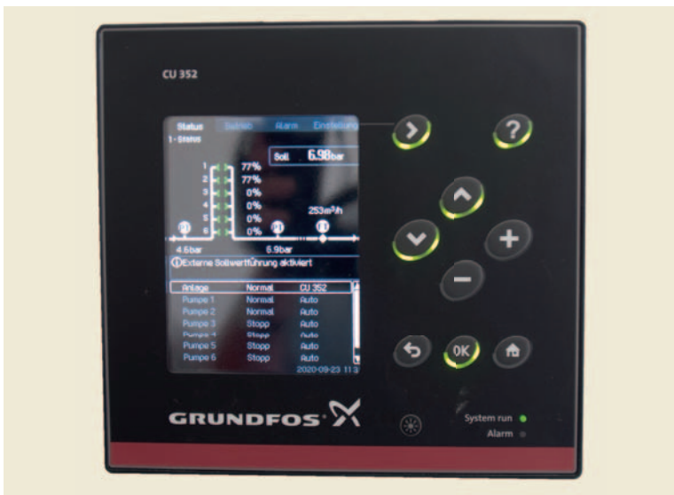
Display zeigt den Einsatzstand der Pumpen am 23.09.2020 um 11.30 Uhr. Zwei Pumpen sind im Einsatz mit je ca. 77% Leistungsvolumen.
