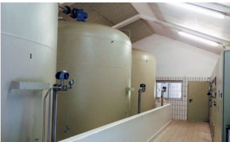
Die Steuerung der Brunnenpumpen erfolgt über eine externe Steuerungsanlage mit BUS Technologie. Damit ist eine betriebssichere und gleichmäßige Belastung der Brunnenpumpen sichergestellt.
