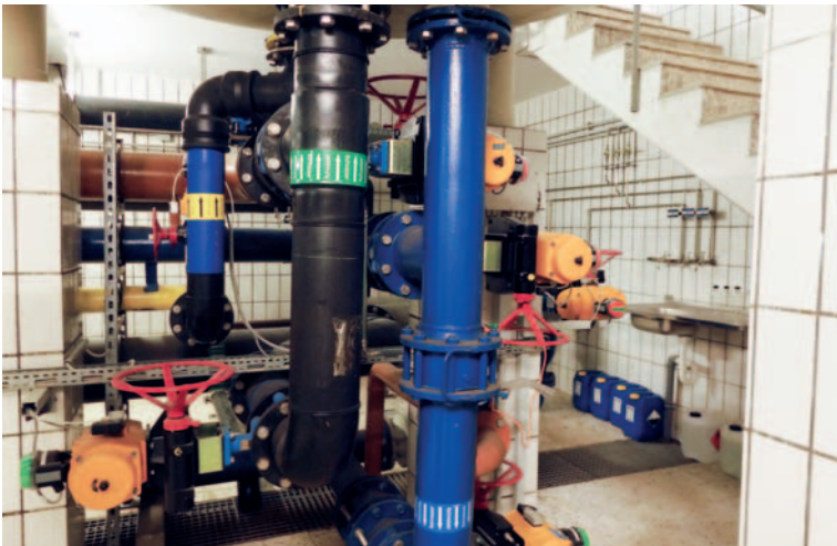
Im Wassergewinnungsbereich Farnwiese wird das aus 3 Tiefbrunnen gewonnene Rohwasser nach der Trübungsmessung in einer Entsäuerungsanlage aufbereitet
