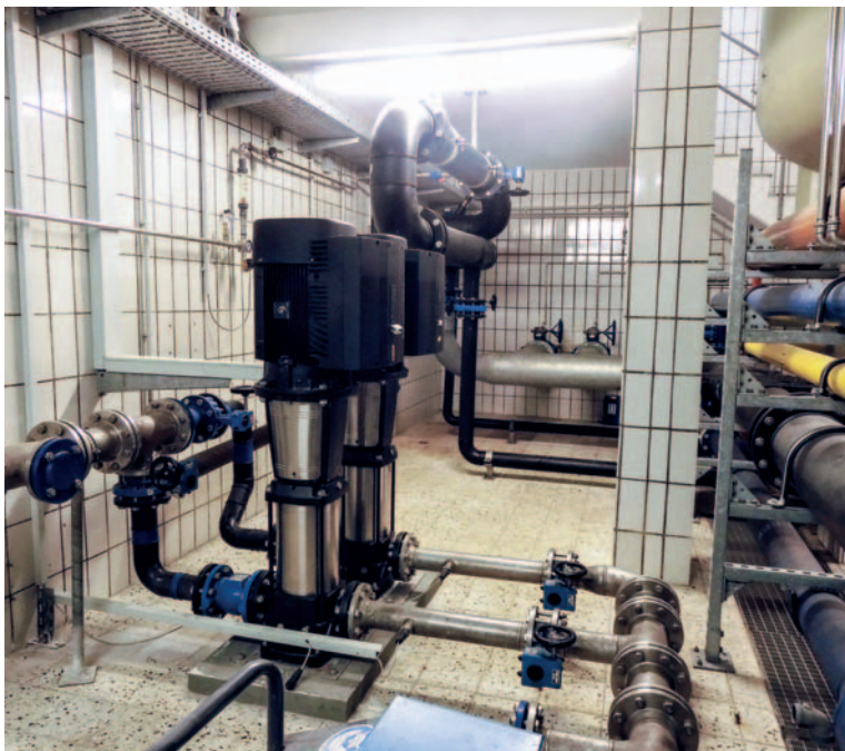
Mittlerweile ist die gesamte Pumpentechnik ausgetauscht worden.: 2 CRE 45-4 fördern das Trinkwasser in den Hochbehälter Oberseebach
