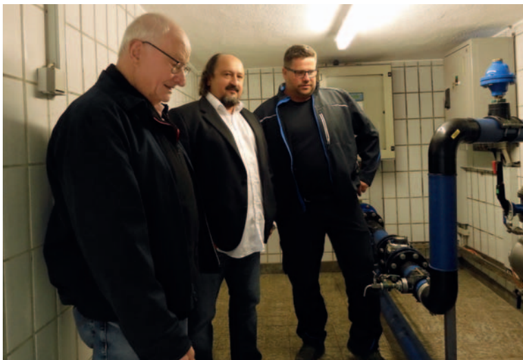
Anlagenkontrolle: Friedel Dörr, Vorstand WBV Niedernhausen/Naurod (links), Michael May, Wassermeister (rechts) und Matthias Kaufmann, Gebietsrepräsentant Grundfos GmbH (Mitte)
