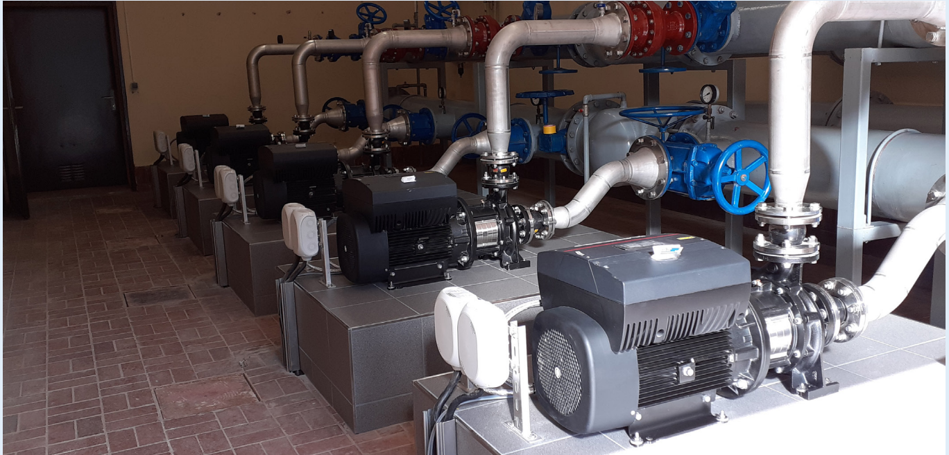
Druckerhöhungsanlage Neustrelitz / Kiefernheide - 5 NBE 65-200/198 Blockpumpen mit Steuerung CU 352
