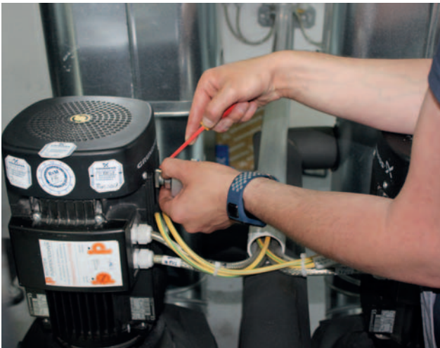
Montage der Sensoren. Gemessen werden dreiaxiale Schwingungen, Oberflächentemperatur und magnetischer Fluss.
