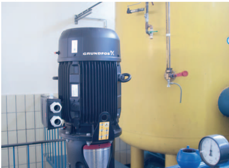
CR125-4 Die Steuerung der Pumpe ist abhängig vom Abnahmeverhalten im Netz bzw. abhängig vom Füllstand im Hochbehälter
