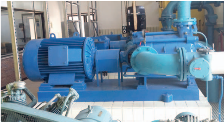
Die Altanlage auf einen Blick. Drei Einzelpumpen mit der jeweiligen Steuerung. Die Anlage ist ausgelegt auf jeweils rund 800.000 m 3 /anno bzw. 80 m 3 /h je Einheit.
