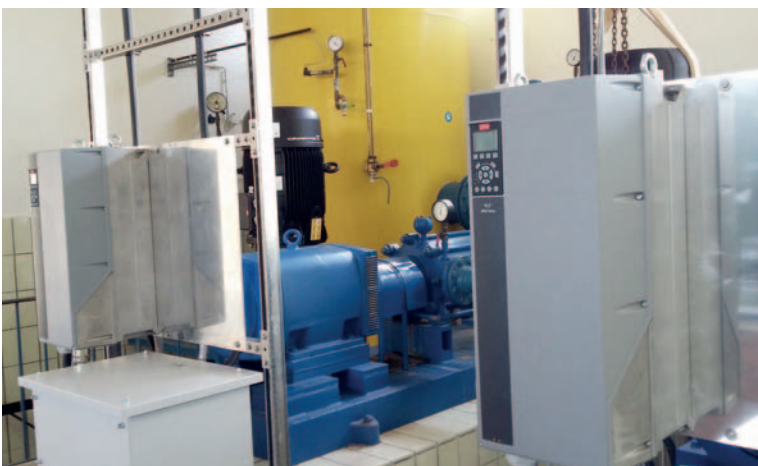
Die neuen Grundfos CR 125-4 sind für den Austausch bereit. Im Bedarfsfall kann jede Pumpe bis 130m 3 /h Trinkwasser fördern, bei gleichzeitig deutlich niedrigerem Energieeinsatz
