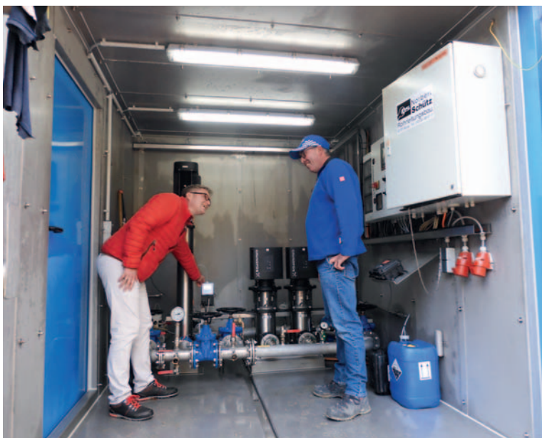
Einsatzbesprechung im Container beim Übergabebauwerk in Wemding. Links: Christopher Filchner, Key Account Manager, Grundfos GmbH, rechts: Anton Schütz, Rohrnetzmeister Oberbauleiter und Geschäftsführer Norbert Schütz GmbH & Co.KG, Boos
