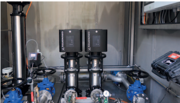
Die komplette Pumpentechnik mit der jeweiligen Steuerung ist im Container montiert. Die Anlage kann jederzeit - auch kurzfristig - eingesetzt werden.
