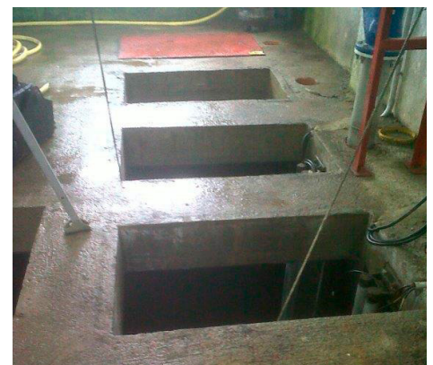
Die Pumpenschächte. Die Pumpen sind nass aufgestellt.
