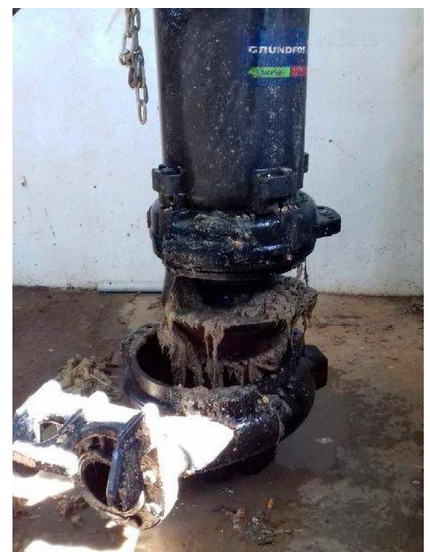
Beispiel einer Verstopfung der alten Pumpen.
