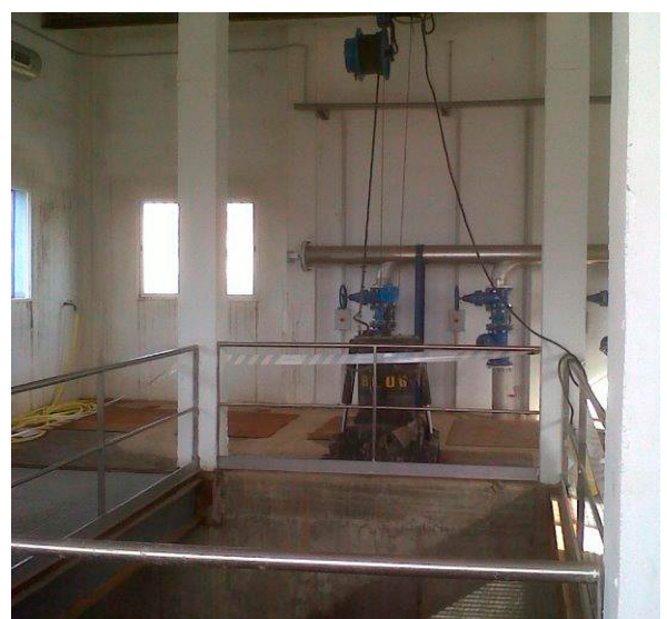
Das Innere der Pumpstation.
