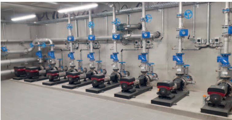
Für die Beschickung der Sand- und Kohlefilter sowie für die Rückspülung werden frequenzgeregelter Normpumpen eingesetzt
