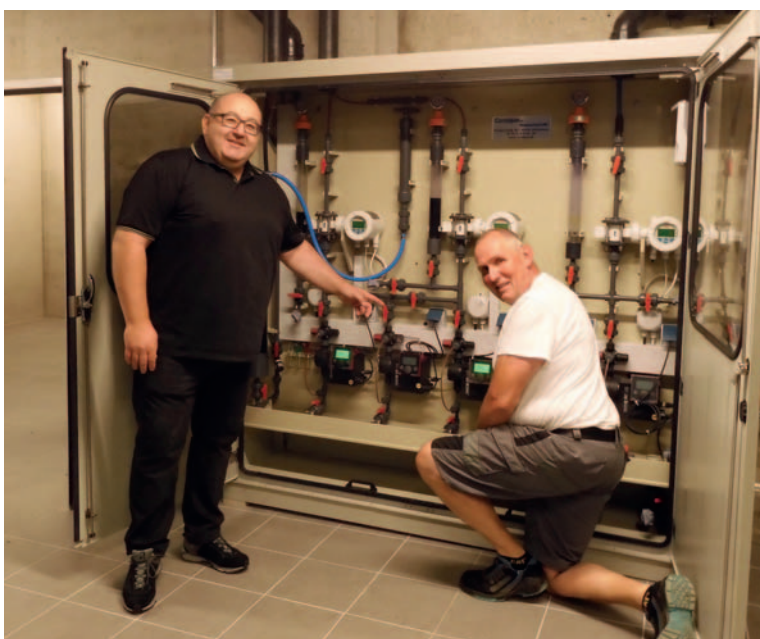
Kontrolle der eingesetzten Dosierpumpen. rechts: Betriebsleiter Karl Steck, links: Vertriebsrepräsentant Grundfos Maik Wötzel
