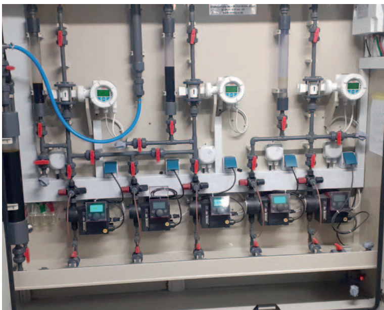
Zudosierung von Eisen III erfolgt mittels 5 Dosierpumpen DDA 30-4 AR
