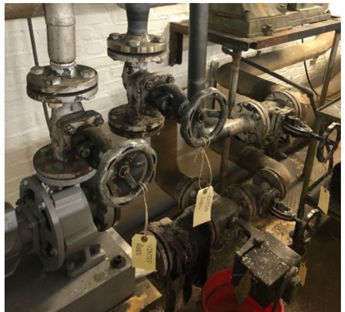
Εικόνα: Ένας βρόχος ανάμειξης της Envasen πριν την τοποθέτηση του MIXIT.
