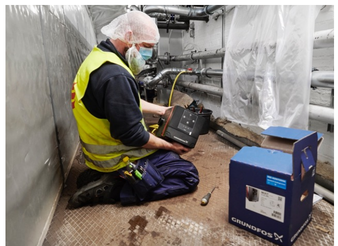
Εικόνα: Εγκατάσταση ενός Grundfos MIXIT στην Envas στο Οντένσε της Δανίας.
