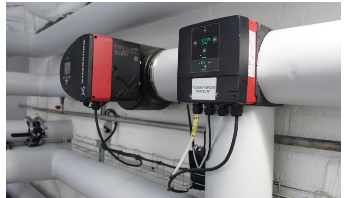
Εικόνα: Ο βρόχος ανάμειξης μετά την τοποθέτηση του MIXIT. Η μονάδα Grundfos MIXIT βρίσκεται στα δεξιά και ένας κυκλοφορητής Grundfos MANGA3 βρίσκεται στα αριστερά.
