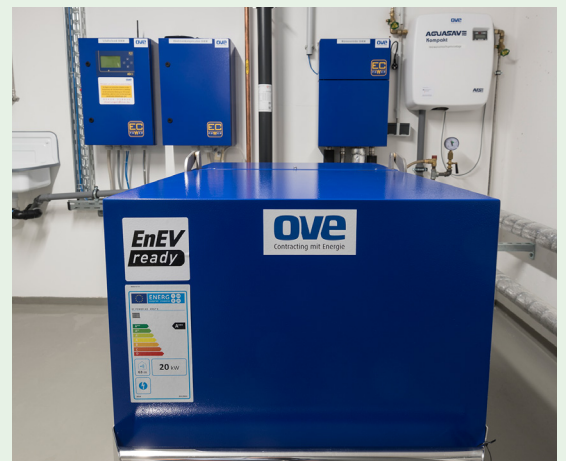
El generador de calor principal es un sistema de cogeneración compacto con 21 kW de potencia térmica y 9 kW de potencia eléctrica
