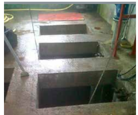
Los pozos de las bombas. La instalación de las bombas es cámara húmeda.
