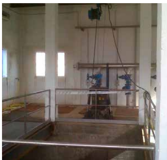
Un vistazo al interior de la estación de bombeo.
