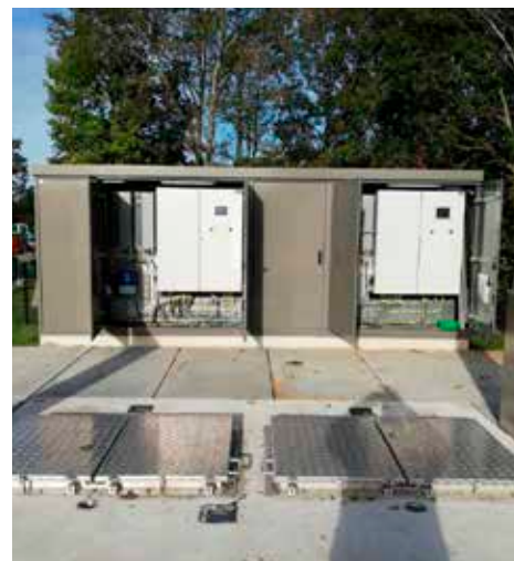
Pumppuja ohjataan taajuusmuuttajilla..
