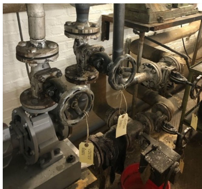
Kuva: Envasen-sekoituspiiri ennen MIXIT-ratkaisun jälkiasennusta.
