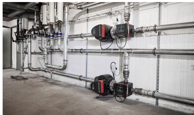
Kuva: Kaksi juuri asennettua sekoituspiiriä, Grundfos MIXIT-ratkaisut ja MAGNA3-pumppu Envases-yhtiön tiloissa.
