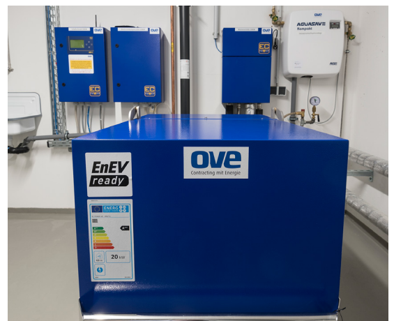
Lämmöntuotannosta vastaa pääasiassa lämmön ja sähkön yhteistuotanto, joka tuottaa 21 kW lämpöä ja 9 kW sähköä.
