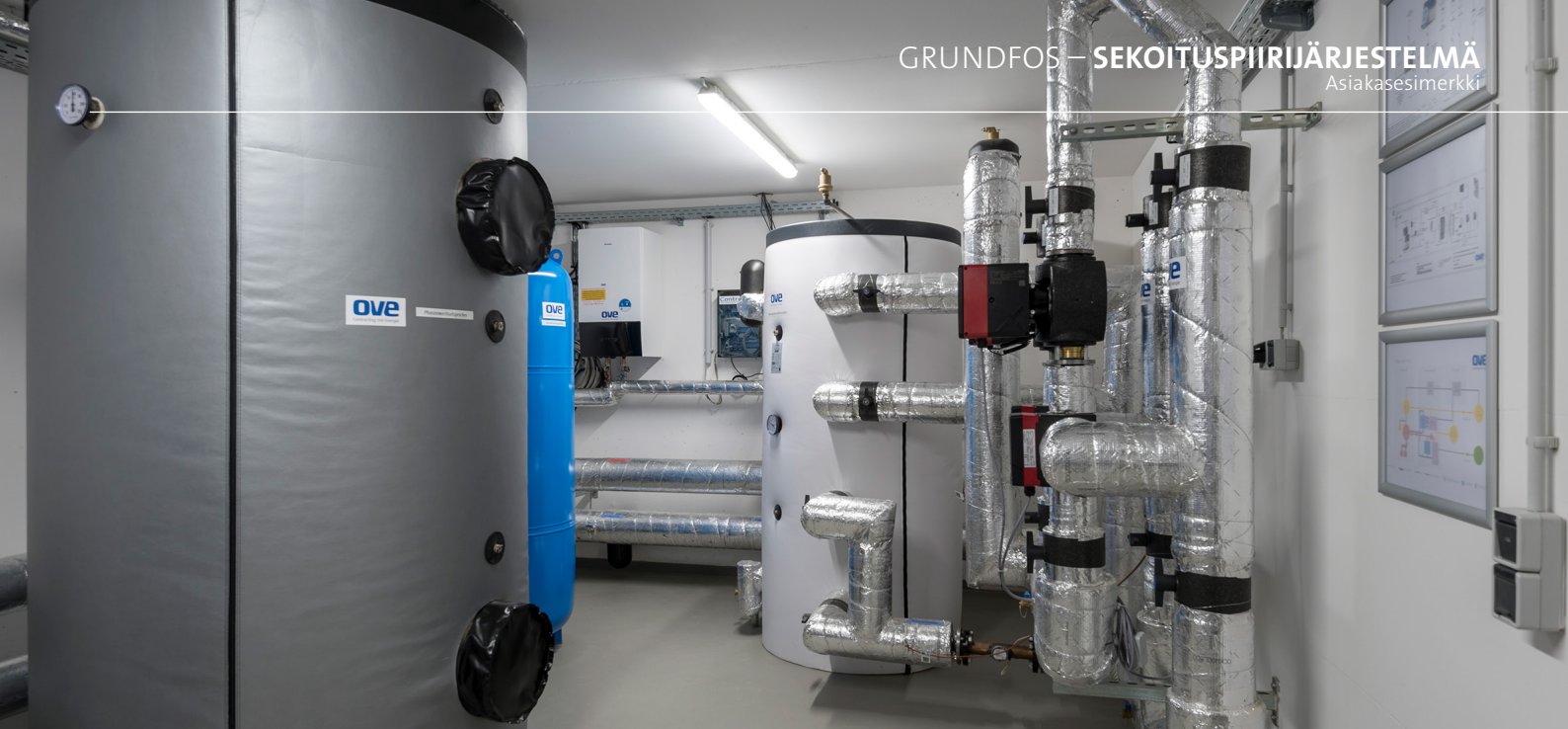
Asuinkiinteistön lämmönjakohuone, jossa on lämmön ja sähkön yhteistuotantolaitos, PCM-materiaalilla toimiva puskurivarastosäiliö, lämpöpumppu ja sekoituspiirit.
