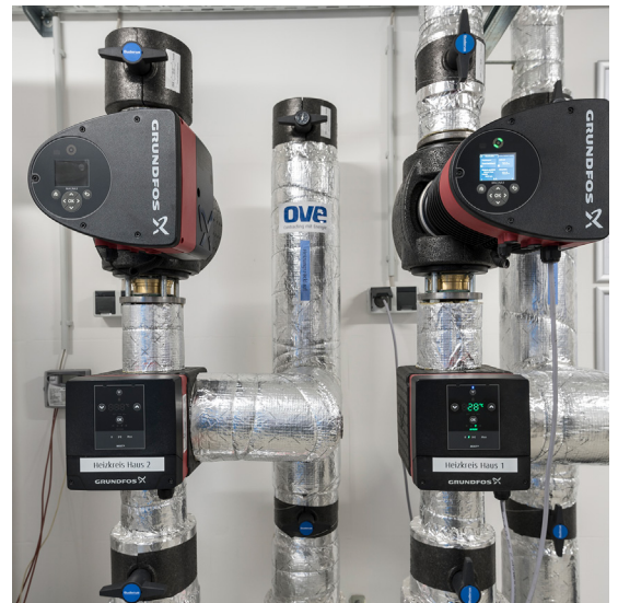
Rakennusvaiheen 1 sekoituspiiri (oikealla) ja rakennusvaiheen 2 sekoituspiiri (vasemmalla). Molemmissa on MIXIT-ohjausyksikkö ja toisiopiiriin MAGNA3-pumppu.
