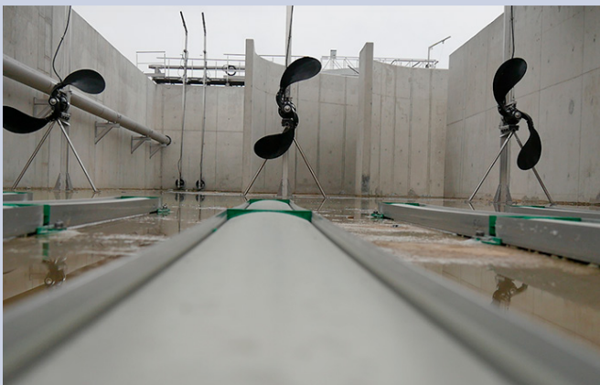
Agitateurs Grundfos permettant de moderniser le bassin de traitement à Tomaszów.
