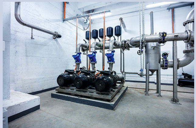
La centrale de Tomaszów Mazowiecki utilise un groupe de surpression Grundfos Hydro MPC pour le traitement de l'eau. « Je travaille avec Grundfos pour tous mes projets en Pologne », déclare Adam Bierut, conducteur de travaux chez Cadagua.
