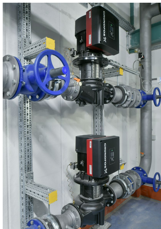
Szivattyúrendszer a hűtővíz száraz hűtőtornyba történő szivattyúzására
