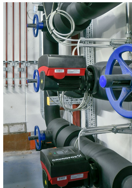
Hűtővíz-szivattyúk a hideg közeg szivattyúzásához a Zortström elosztóhoz
