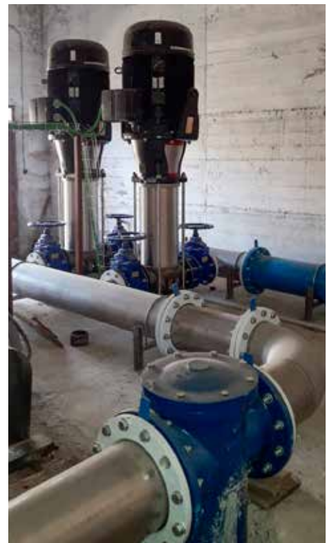
Due pompe Grundfos CRN garantiscono una fornitura affidabile di acqua a migliaia di persone.
