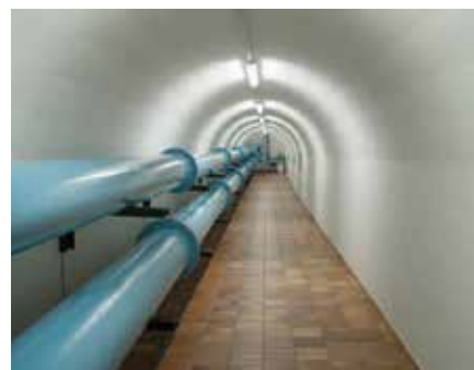
"Caverna 2" - uno dei serbatoi sopraelevati. La tubatura alimenta i due bacini di stoccaggio di 3.000 m 3 che immettono l'acqua nel sistema di approvvigionamento della città
