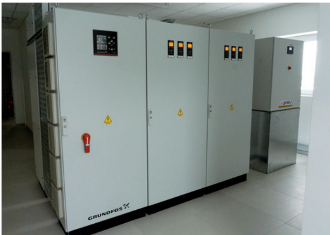
Al piano superiore è stato predisposto il quadro elettrico, con il sistema elettronico DDD (Demand Driven Distribution) che gestisce e verifica l'attività delle pompe.
