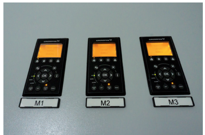
Pannelli fronte quadro dei convertitori di frequenza.
