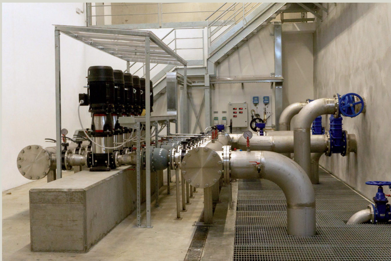
Al piano terra della nuova centrale è stata collocata una soluzione multistadio verticale costituita da 6 pompe CR XL collegate a due vasche di stoccaggio: da qui l'acqua viene pompata in rete raggiungendo la maggior parte delle utenze del territorio comunale.
