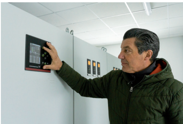
Roberto Massimo , Responsabile Impianti per Alpi Acque, monitora il lavoro delle due pompe in funzione: trend delle pressioni, portate di rete e livelli dei serbatoi.
