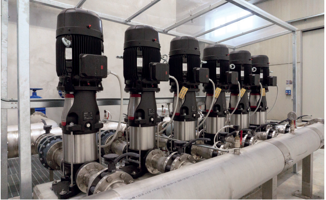
La nuova stazione di pompaggio di Fossano assicurerà ad Alpi Acque un efficientamento energetico rilevante : il gestore avrà la possibilità di ridurre da 1,6 mln a 900mila kW/anno i suoi consumi, con un risparmio di energia elettrica di oltre il 40% rispetto al passato.
