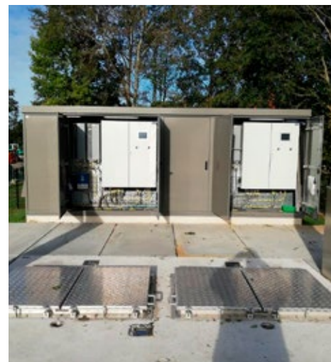
Le pompe funzionano con convertitori di frequenza.
