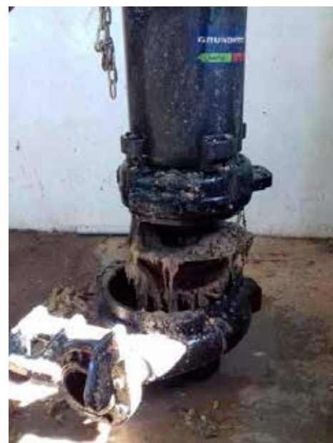
Un esempio di intasamento in una delle vecchie pompe.
