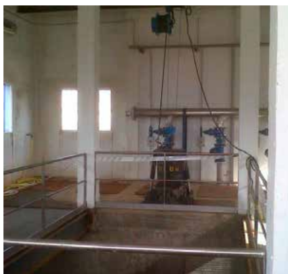
La stazione di pompaggio.
