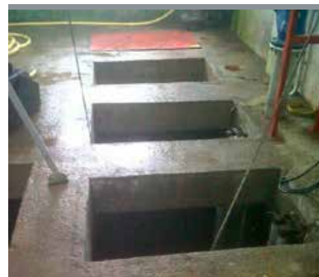
I pozzi delle pompe. Le pompe sono sommerse.
