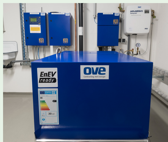
De hoofdwarmtegenerator is een compacte wkk-installatie met een thermisch vermogen van 21 kW thermisch en een elektrisch vermogen van 9 kW.
