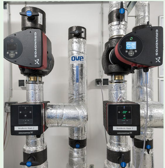
Menggroepen voor bouwfase 1 (rechts) en 2 (links), elk met MIXIT-regelmodule en secundaire MAGNA3-pomp
