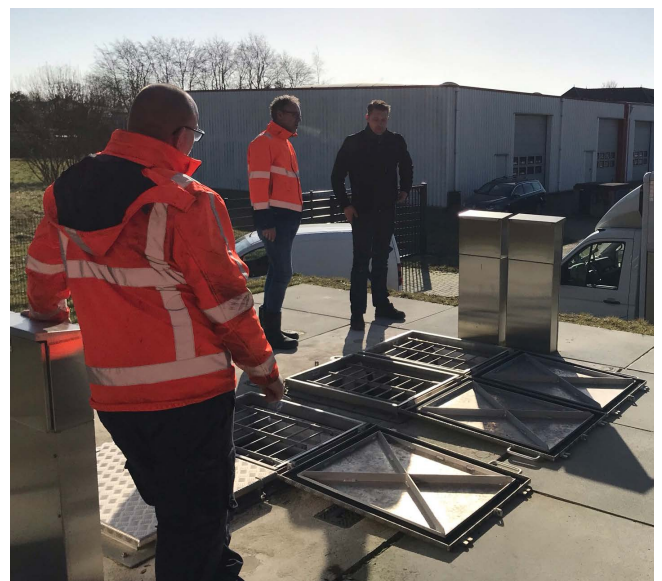
De tevreden Operations Manager Ivo ten Brinke (rechts) geeft een rondleiding bij de nieuwe pompput.
