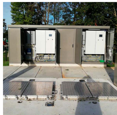
De pompen worden aangedreven door frequentieregelaars.
