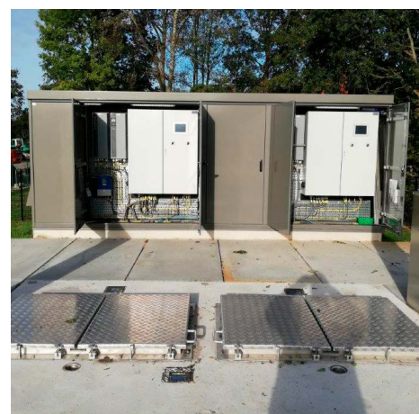
De pompen worden aangedreven door frequentieregelaars.
