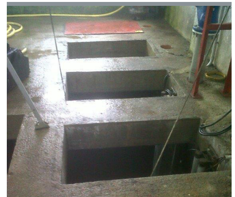
De pompputten. De pompen staan nat opgesteld.
