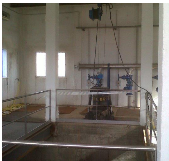
Een kijkje binnen in de pompput.
