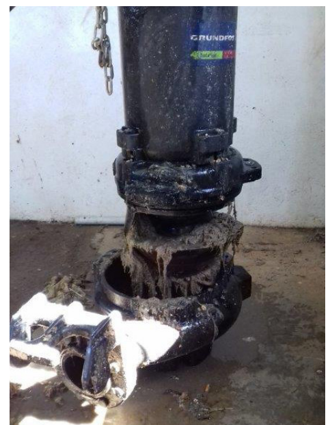
Een voorbeeld van verstopping in één van de oude pompen.
