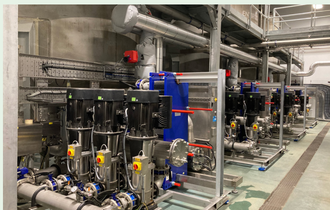
De fire Hydro MPC-E-trykkøkningssettene med Grundfos CR-pumper.
