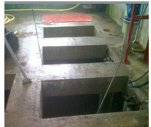
Studzienki pompowe. Pompy w instalacji zatapialnej.
