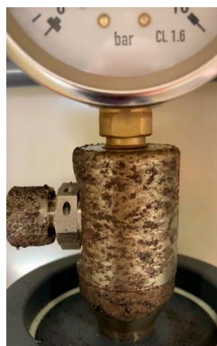
Powierzchnia metalowa skorodowana wskutek działania oparów HOCl
