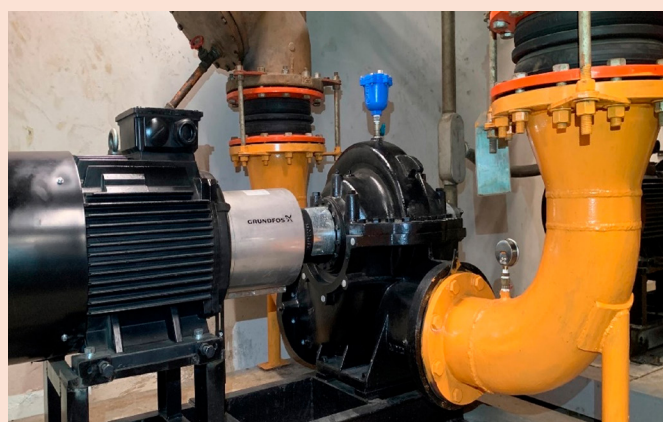
Bomba de água do condensador do chiller Grundfos
